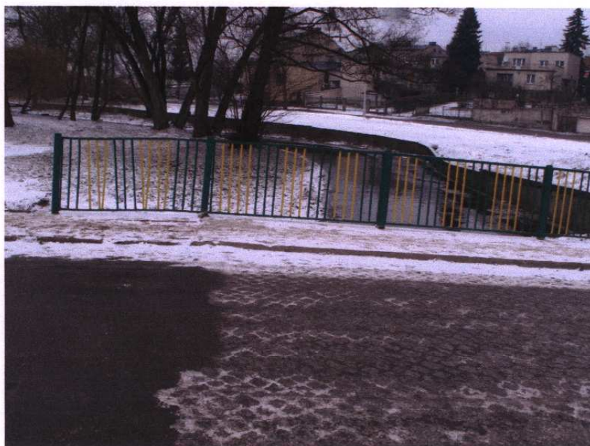
Fot. 14. Deformacja balustrady po stronie dolnej wody na skutek osiadania przyczółka prawobrzeżnego.
