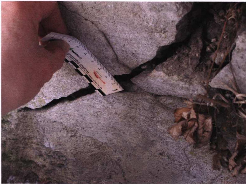
Fot. 30. Rozwarcie szczeliny ok. 1,0 cm nad przyczółkiem lewobrzeżnym od strony dolnej wody.
