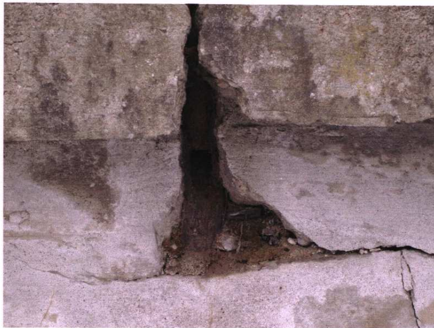
Fot. 17. Korozja zbrojenia i słupka balustrady w szczelinie nad przyczółkiem lewobrzeżnym.
