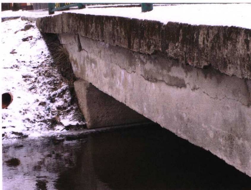
Fot. 21. Rozwarstwienie na całej długości przęsła od strony górnej wody.
