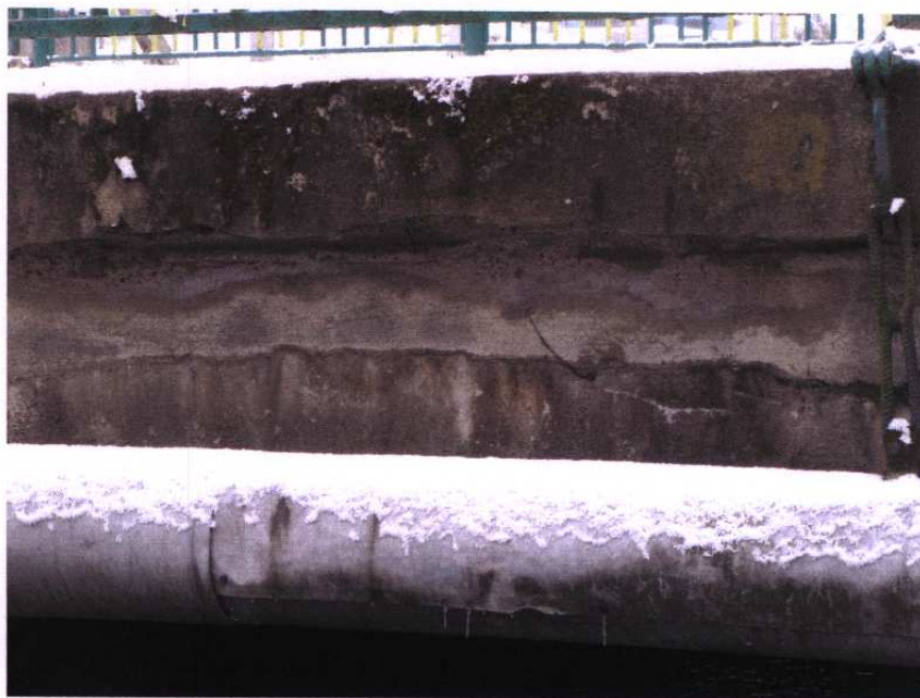
Fot. 9. Rozwarstwienie, korozja betonu, wylugowania na skutek nieszczelnej izolacji.
