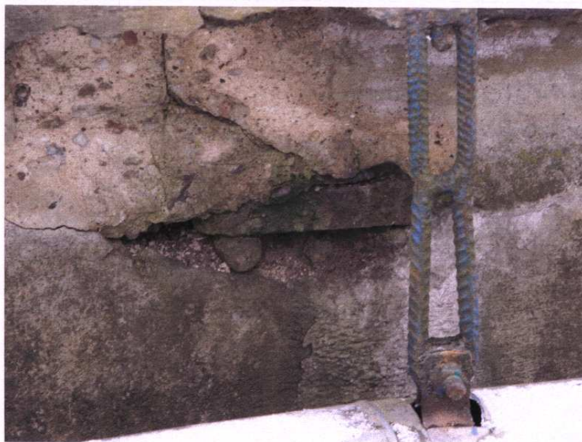
Fot. 11. Znaczny ubytek zlej jakości betonu i zaawansowana korozja zbrojenia.
