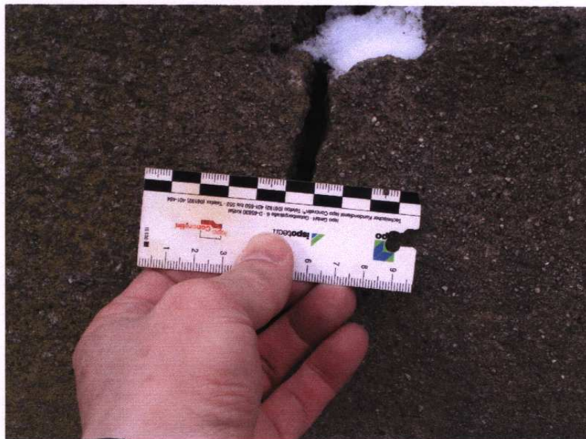
Fot. 32. Rozwarcie szczeliny ok. 1,0 cm nad przyczółkiem prawobrzeżnym od strony górnej wody.
