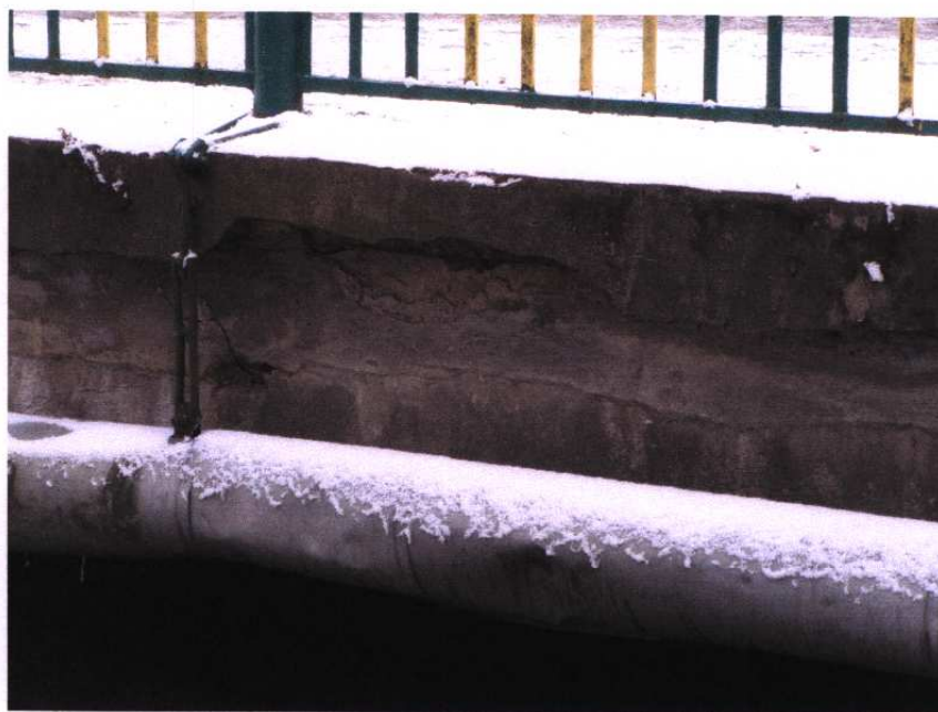
Fot. 7. Rozwarstwienie poziome płyty przęsła od strony dolnej wody.
