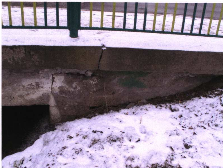
Fot. 19. Odspojenie skrzydła prawobrzeżnego od strony górnej wody.
