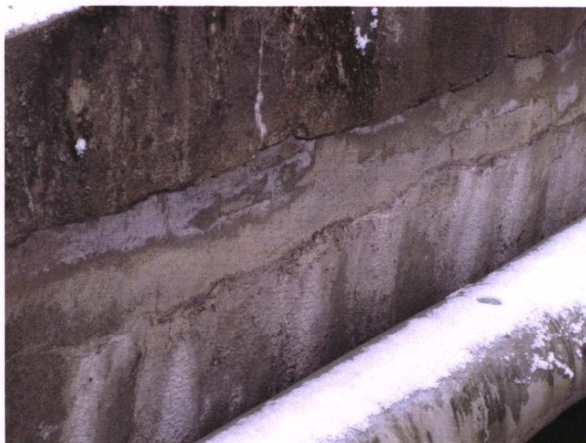
Fot. 12. Intensywne wylugowania od strony dolnej wody.
