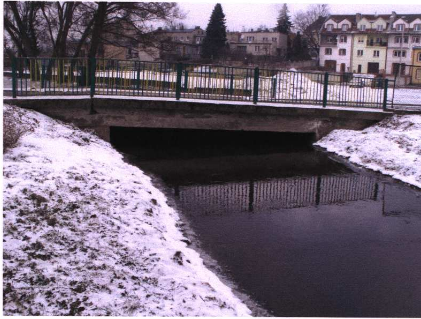
Fot. 5. Widoczne znaczne osiadanie przyczółka prawobrzeżnego
