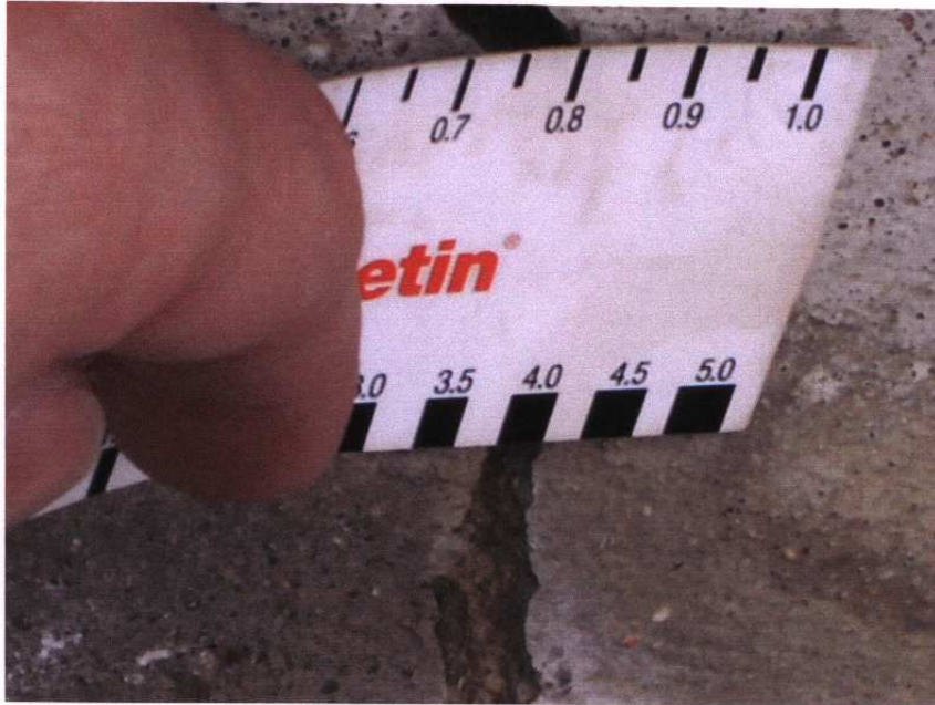
Fot. 29. Rozwarcie szczeliny ok. 4,0 mm nad przyczółkiem lewobrzeżnym od strony górnej wody.
