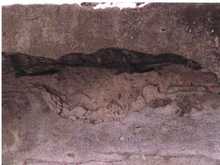
Fot. 8. Ubytek betonu gzymsu i korozja zbrojenia. Widoczny zły jakości beton.
