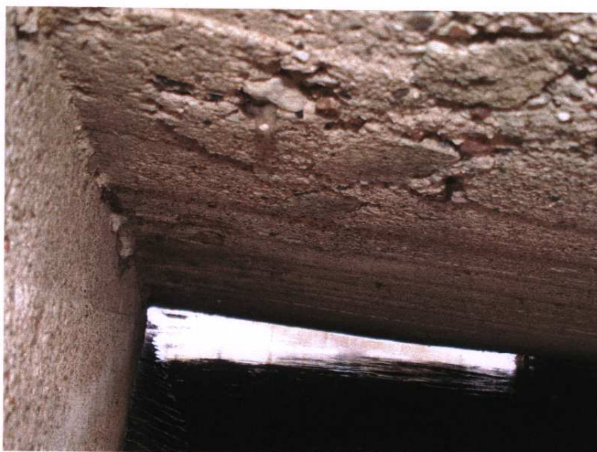
Fot. 24. Złej jakości, jamisty i skorodowany beton spodu płyty przęsła.
