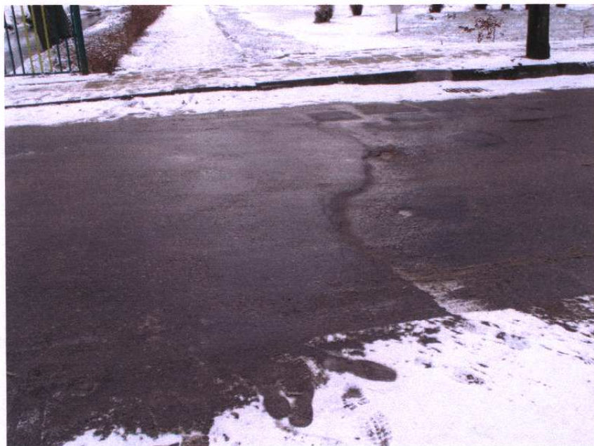
Fot. 26. Nierówności, deformacje i ubytki nawierzchni bitumicznej na dojeździe do mostu.
