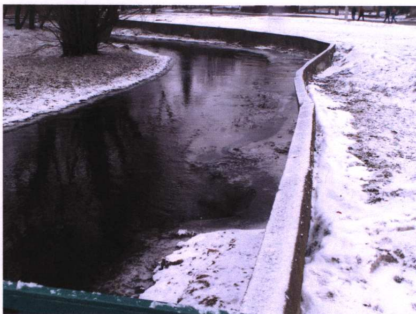
Fot. 10. Znaczne przemieszczenie i obrót ściany oporowej umocnienia prawego brzegu od strony dolnej wody.
