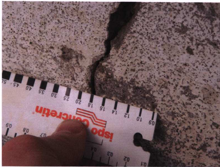
Fot. 31. Rozwarcie szczeliny ok. 1,8 mm nad przyczółkiem prawobrzeżnym od strony górnej wody.
