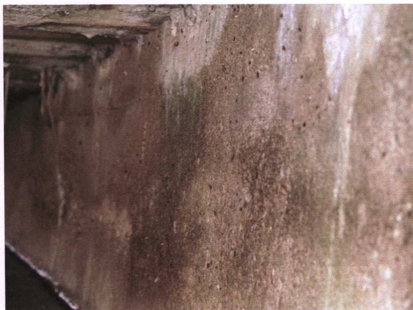
Fot. 22. Korozja ściany przyczółka prawobrzeżnego. Widoczny korodujący pręt zbrojenia dolnego płyty przęsła.
