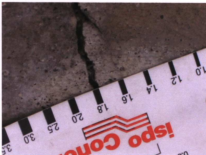
Fot. 28. Rozwarcie szczeliny 1,8 mm nad przyczółkiem lewobrzeżnym od strony górnej wody.
