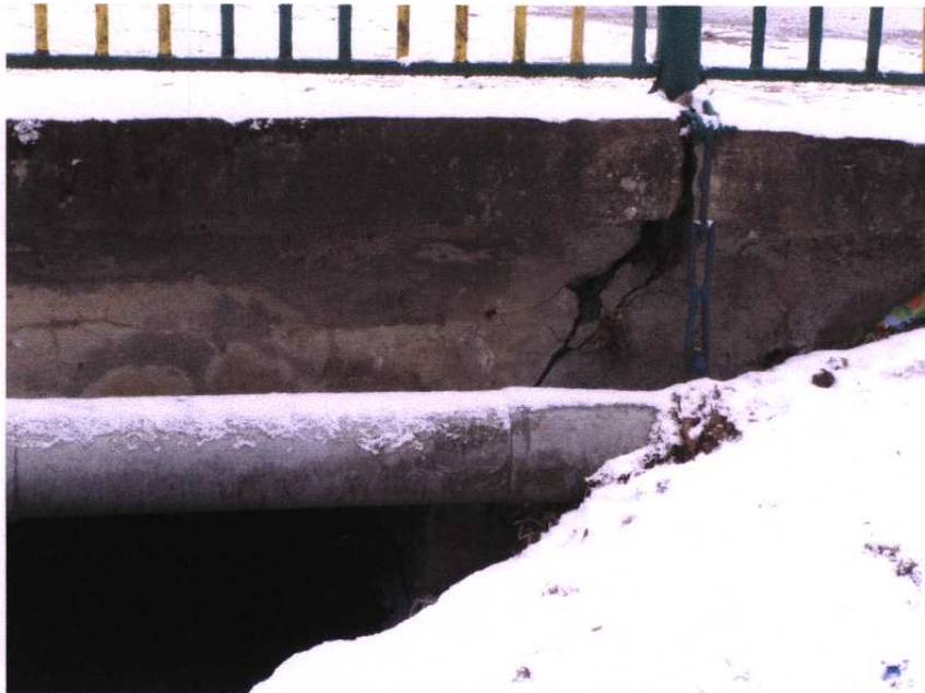
Fot. 6. Pęknięcie płyty przęsła nad przyczółkiem lewobrzeżnym od strony dolnej wody.
