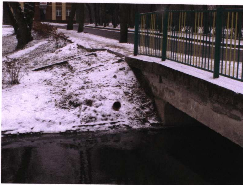
Fot. 23. Brak umocnienia wylotu rury odwodnienia ulicy.
