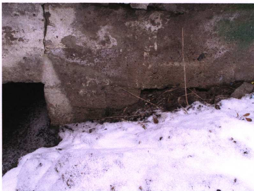
Fot. 20. Destrukcja betonu strefy podporowej przęsła oraz ściany przyczółka prawobrzeżnego.
