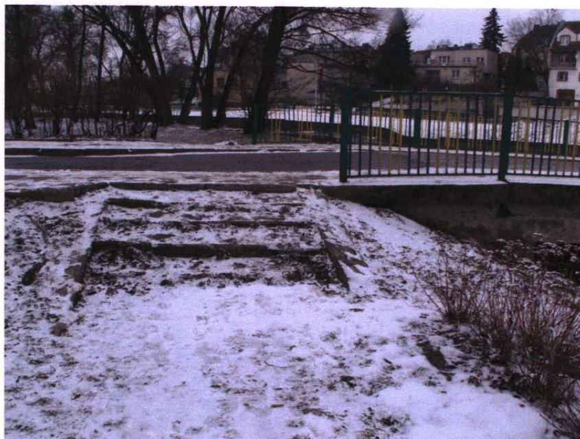
Fot. 27. Zanieczyszczone schody przed obiektem.
