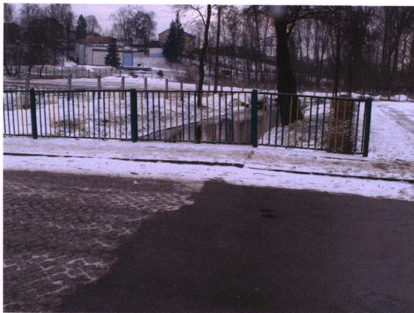
Fot. 13. Załamanie balustrady i uskok w nawierzchni chodnika spowodowane znacznym przemieszczeniem pionowym przyczółka prawobrzeżnego.
