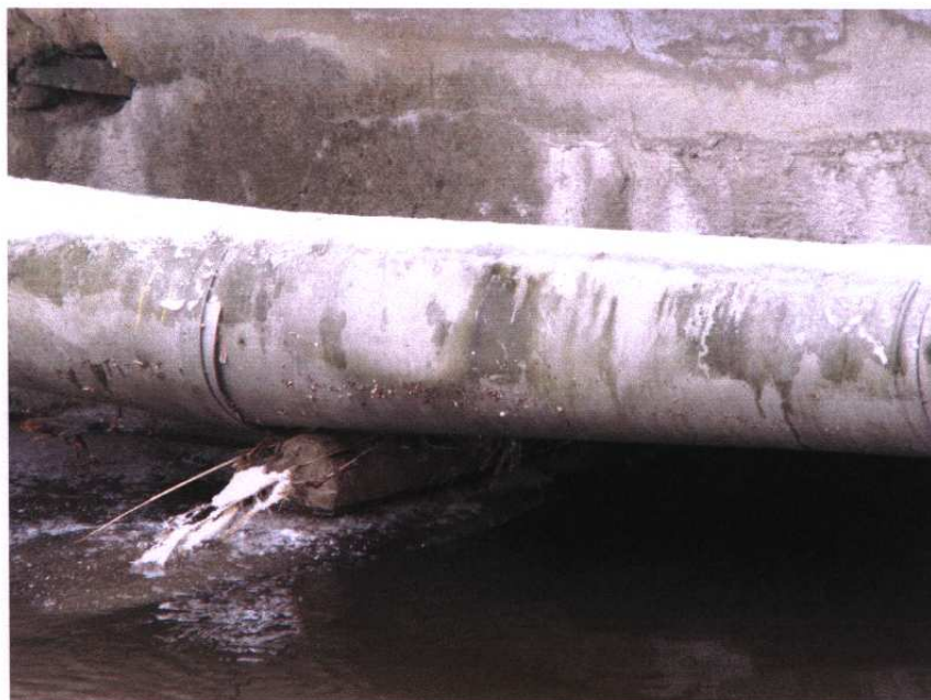
Fot. 25. Zaklinowany pod rurociągiem element drewniany.
