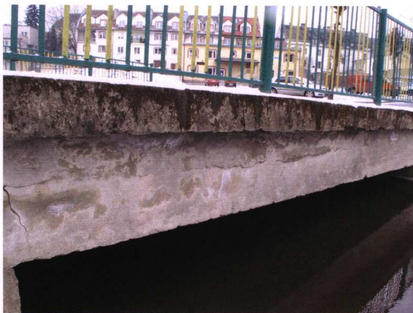
Fot. 18. Rozwarstwienie płyty i korozja (również biologiczna) betonu gzymsu.
