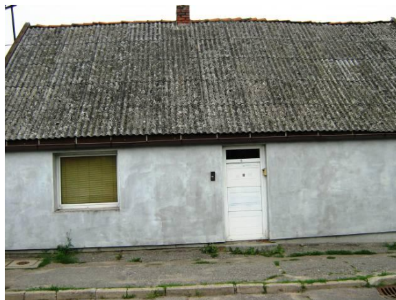
Rys. 7. Pokrycie dachowe ocenione w II stopniu pilności.
